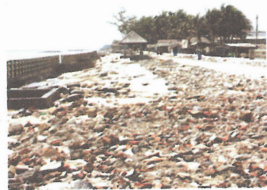
ปี 2550 พื้นคอนกรีตหลังกำแพงแตกเสียหายและ ต้องซ่อมแซมทุกปี
